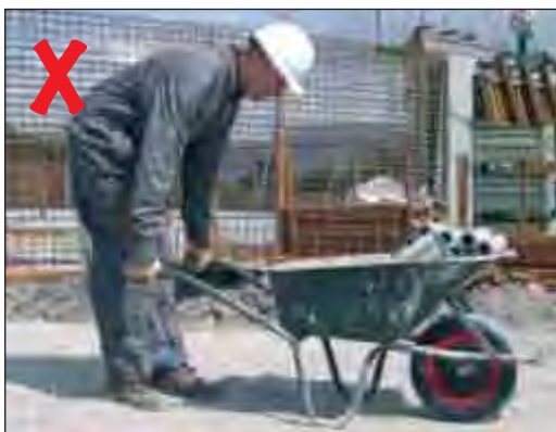
Slechte houding om een kruiwagen te verplaatsen
